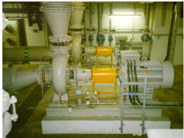
Zwischenkühlwasserpumpe eines 800 MW Braunkohlekraftwerks
