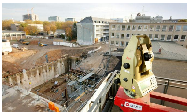
Totalstation zur Bewegungsüberwachung
